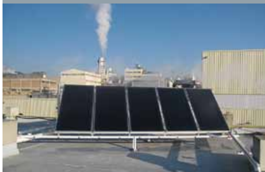
試験プロジェクト：スペインのセビリアとモントルネスの事業所内に小型太陽熱発電システムを設置しました（写真）。このシステムは日射熱を利用して事業所に温水を供給します。
